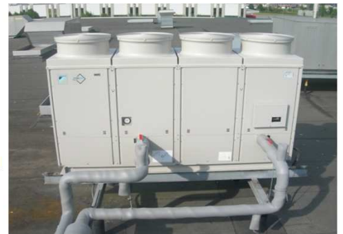
nieuwe Daikin chiller operationeel
